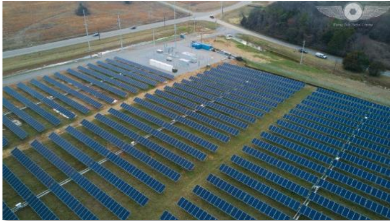
10 MW Solar Array
